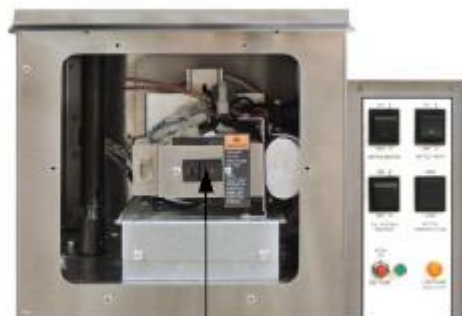
Авт. выкл. котла располагается за крышкой. Снять крышку для доступа к выключателю.
